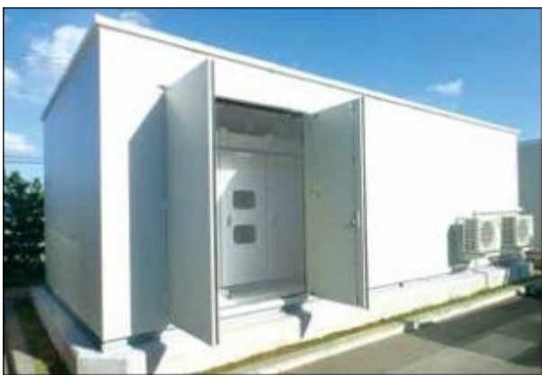
既存キュービクルカバー
