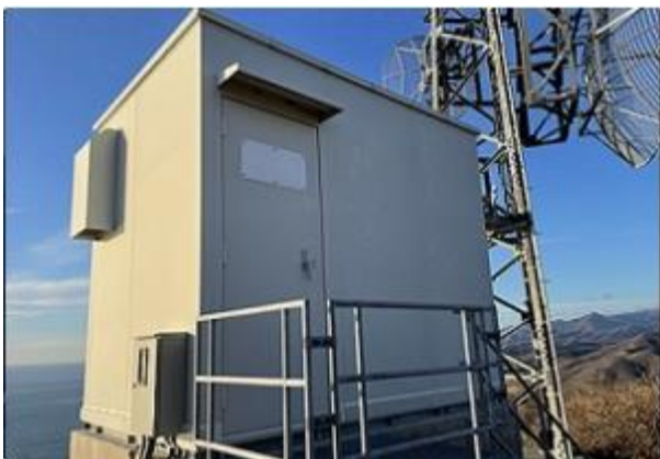
無線中継基地シェルター
